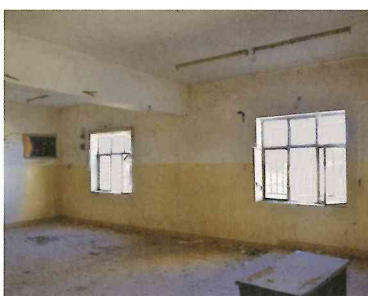
紛争によって破壊された教室
